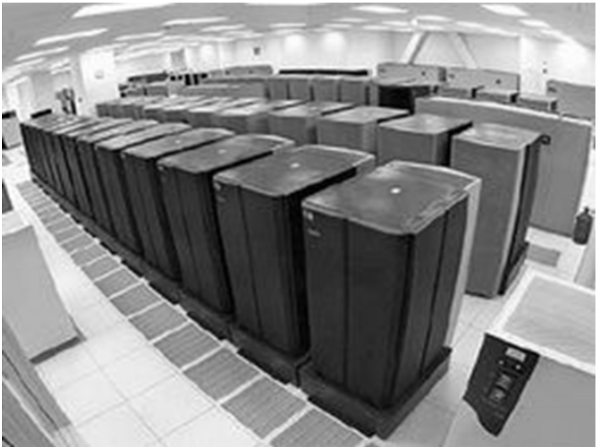
Рисунок 1.18 - Установка серверов Центров хранения и Обработки Данных (ЦОД) в нижних или подвальных этажах производственных, торговых, развлекательных или жилых зданий.
