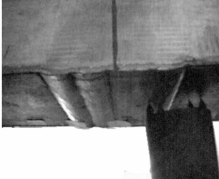
Рис.2.3.5. Датчик установлен в область 4-ой точки
